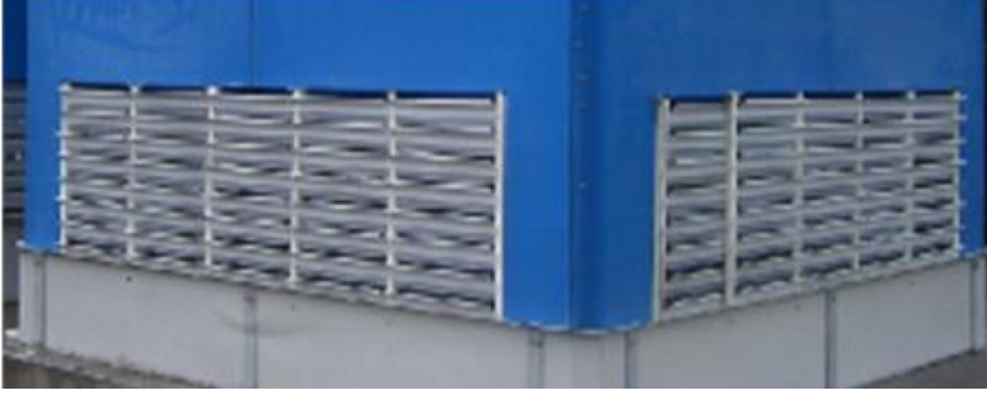
Şekil 5.3-15 Hava giriş panjurları
