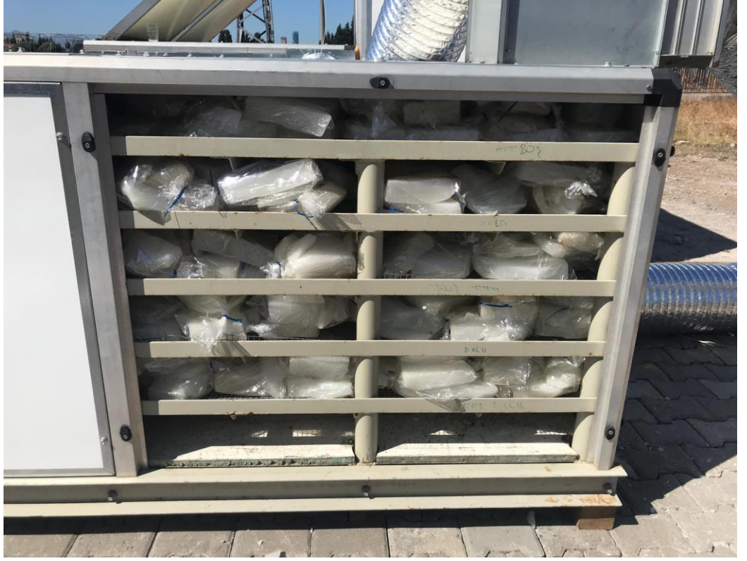
Şekil 4.17. Parafin ısııl enerji depolama sistemi açık hali.
